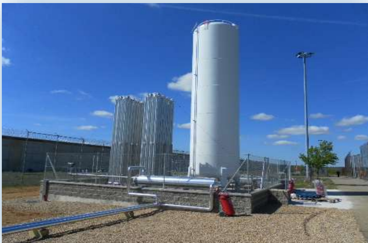
Planta de Gas Natural Licuado. Centro Penitenciario de Topas (Salamanca)
